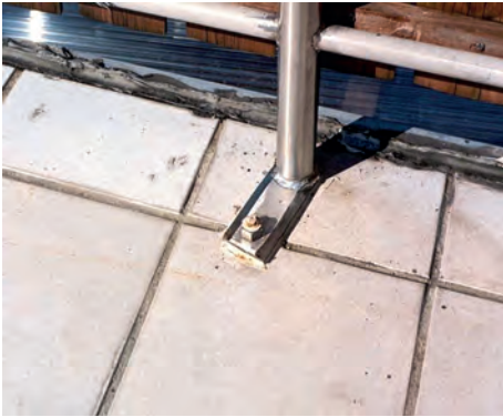
Fehler, das Balkongeländer ist im Belag.
