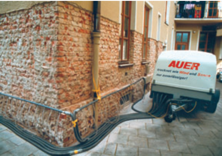
Auer trocknet wie Wind und Sonne, nur zuverlässiger. Dieser Leitspruch wird hier bei einer Mauerwerks-Trockenlegung umgesetzt.
