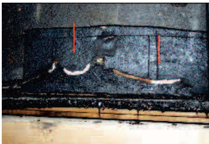
Abb. 3. Konstruktion von außen: Unsachgemäße Bekämpfung, Schadstelle wurde nach Öffnung zugeklebt; der Baumschwamm kann Rinde wie auch Teerbahnen durchbrechen; Foto: P. Newcombe.
