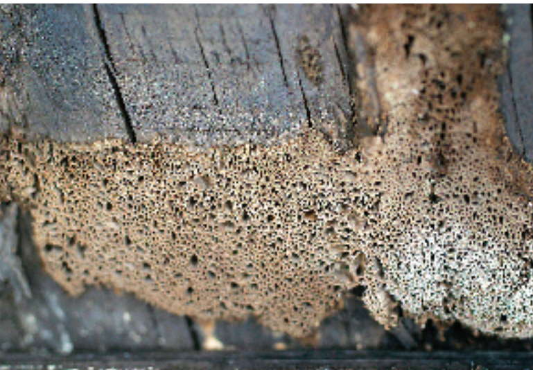
Bild 1: Fruchtkörper an der Unterseite der Dachschalung.
