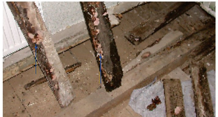
Abb. 6. Nach Öffnung der Konstruktion werden die Fruchtkörper sichtbar (↑). Der Befallsschwerpunkt liegt in der sichtbaren Ecke des Bildes; mutmaßliche Ursache war feuchtes Bauholz im defekten angrenzenden Nassraum.
